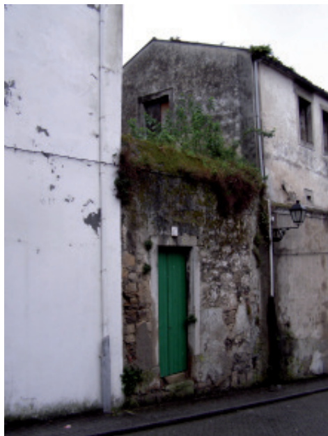
15.- Fotografía actual del acceso al huerto franciscano -puerta verde de la fotografía-, desde la antigua travesía de San Francisco y actual Rúa dos Clérigos. MC-FF.
