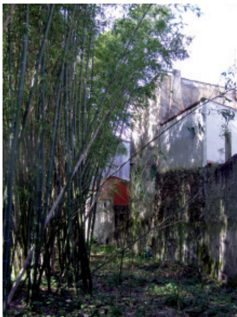
17.- Fotografía del único tramo de la muralla de Betanzos visible en su trazado original tomada desde el huerto franciscano. MC-FF.
